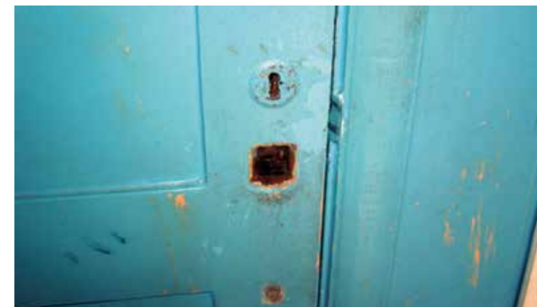
Fechadura quebrada em uma das salas de atendimento deixa profissionais e pacientes constantemente trancados
