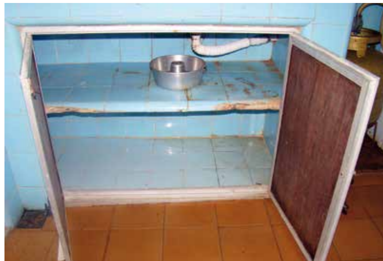
Pia da cozinha é usada para higienização de médicos e de pacientes, por causa de pia quebrada em banheiro
